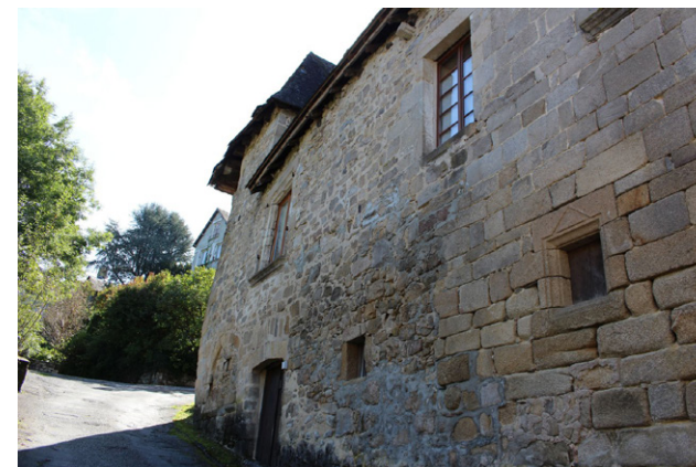
A droite, le parement en pierre de taille est destiné à rester apparent. A gauche, la maçonnerie en moellons de tout venant doit recevoir un enduit.
